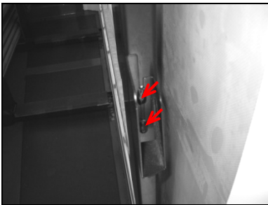
Гнездо на централна стойка
